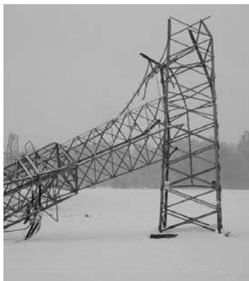
Waren Wartungsmängel Schuld am Umstürzen der Strommasten im Münsterland?
