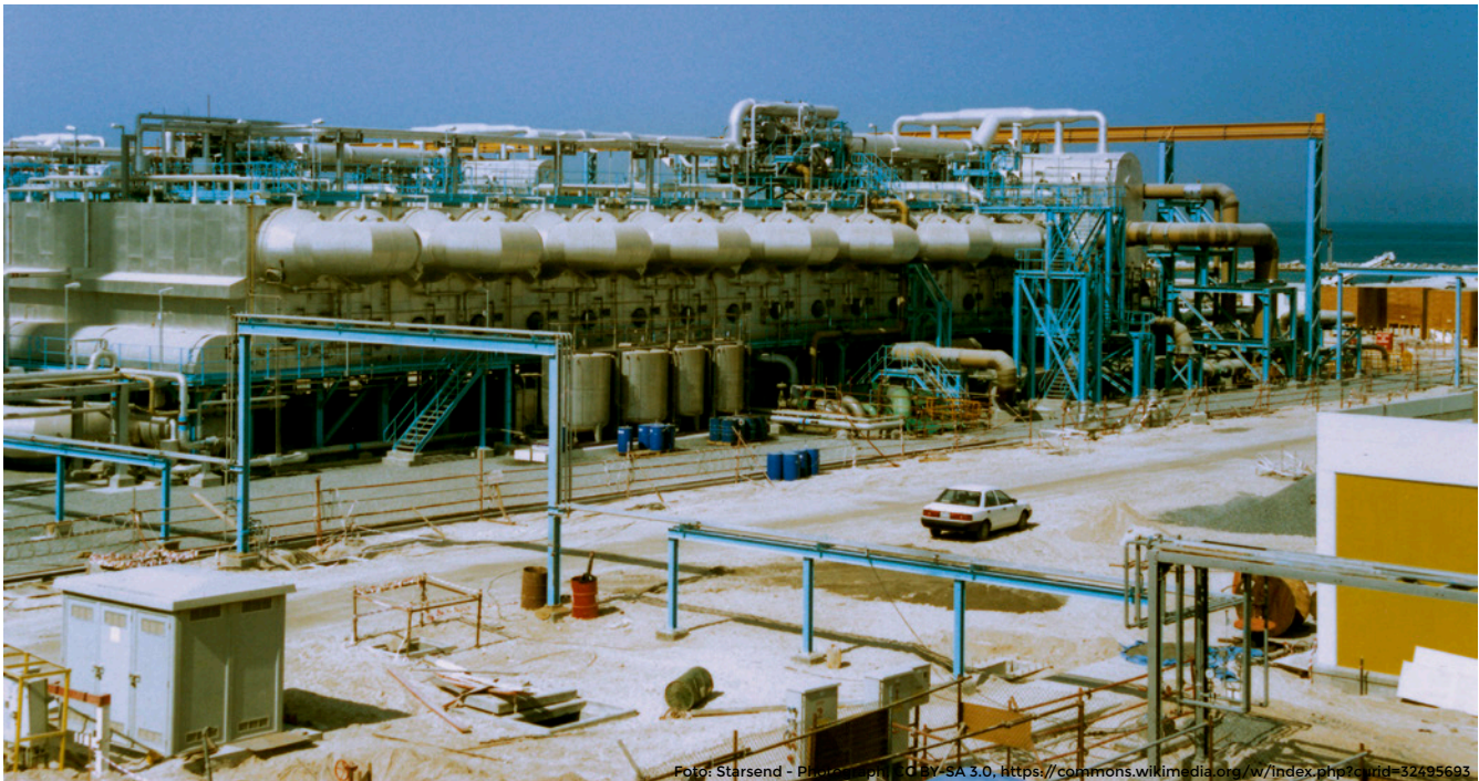
Konventionell betriebene Entsalzungsanlage an der Jebel Ali G Station, Dubai.
